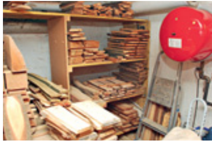
Holz überall: Selbst im Heizungskeller lagert der Rheinländer seine Vorräte.
